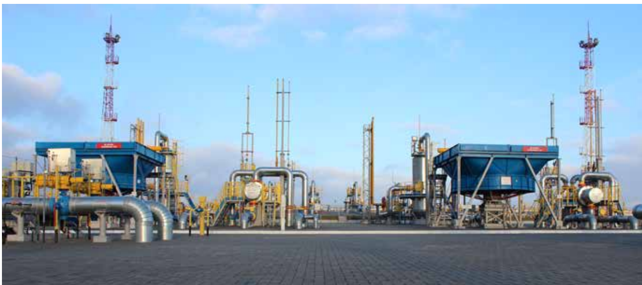
Калининградское хранилище ООО «Газпром ПХГ» в соляных кавернах.
